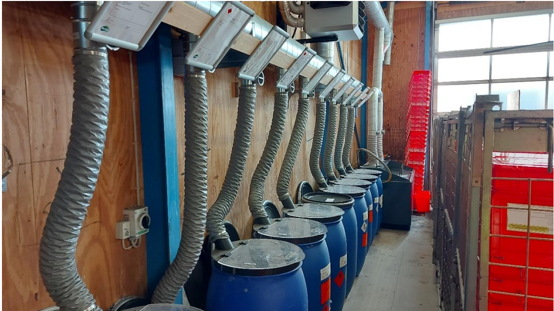
Kemirummet til håndtering af husstandsindsamlede miljøkasser i Løgstør
